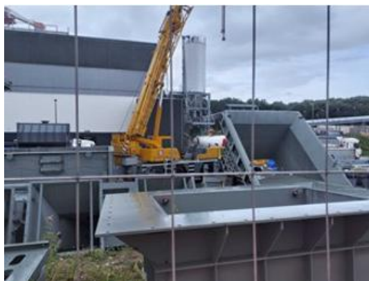
Nouvelle trémie d'alimentation
