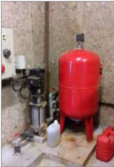
Groupe d'eau industriel dans le local surpresseur
