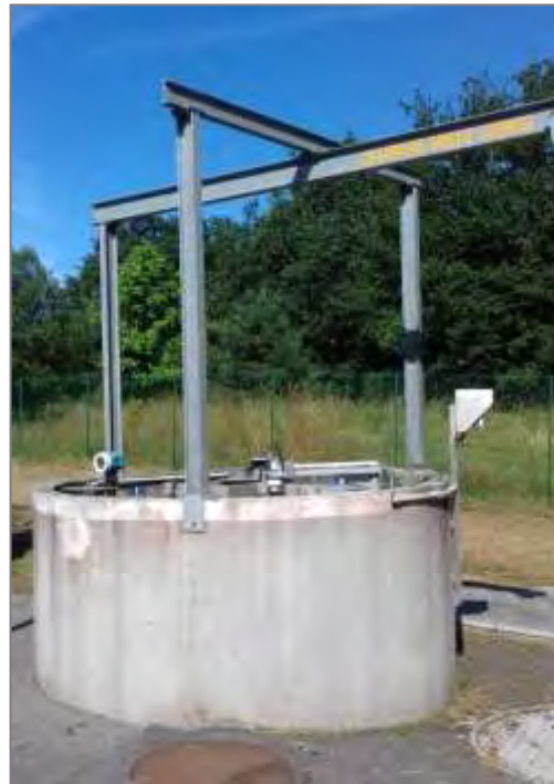
Poste de relèvement des effluents
