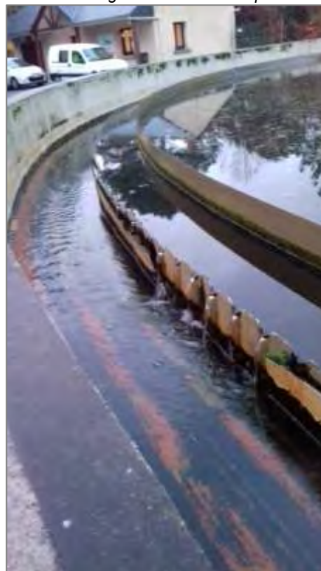
Revêtement de la goulotte du clarificateur à refaire
