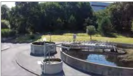
Clarificateur - Dégazeur / Fosse à Flottants – Poste de recirculation
