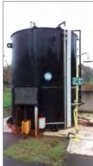
Stockage du chlorure ferrique
