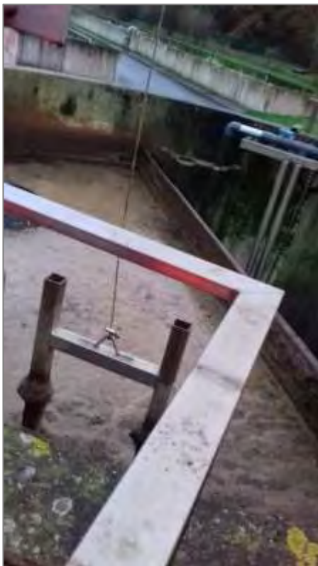
Absence de râclage du dégazeur (vanne fuyarde)
