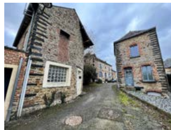
Nouveau percement inadapté
